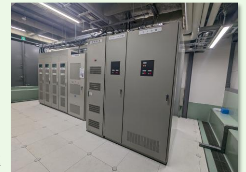
広島駅の回生電力貯蔵装置
