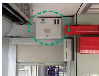
運転状況記録装置本体
